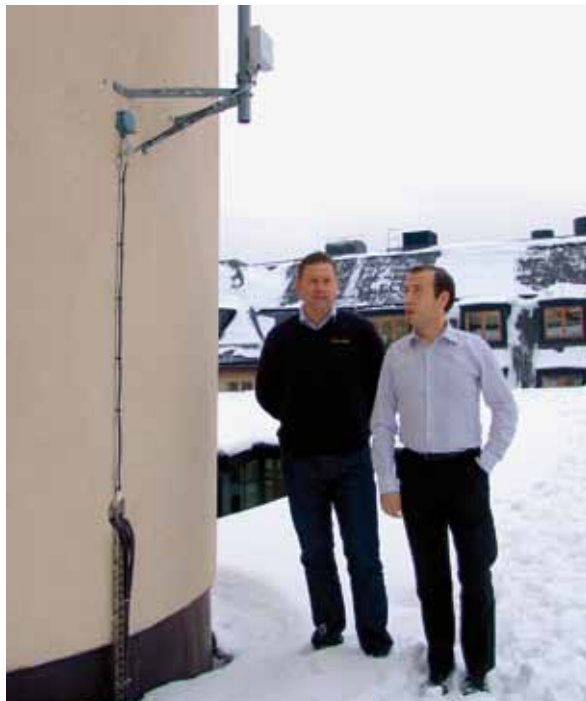
Upp på taket står Tomas Kärki och Andreas Bigl och trivs under donatorantennen, en sektorantenn som är riktad mot en mobilbasstation längre bort.
